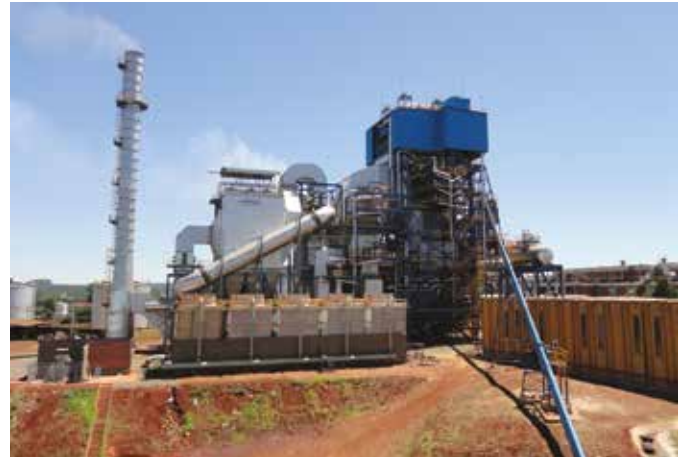
Biomass boiler, Papel Misionero plant, Puerto Leoni, Misiones, Argentina.
